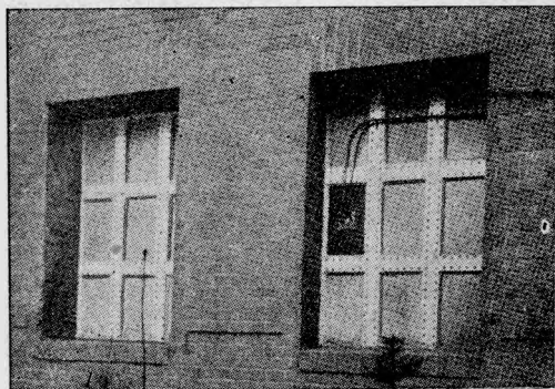
Fig. 6. — Ferestrele camerei pneumatice sunt întărite cu plăci de fier nituite.
